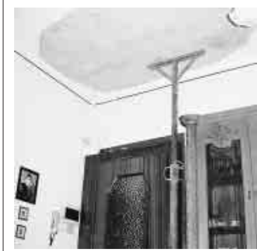
Il soffitto puntellato nella casa dell'Aler a seguito di lavori di manutenzione
